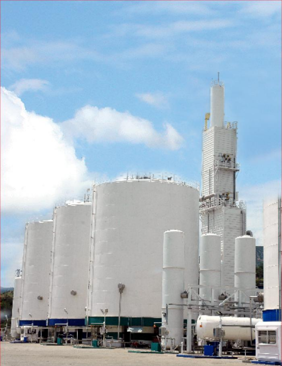
7. Hava ayırma tesisi / Bilecik
